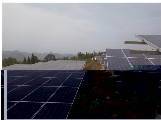
帮扶贫村光伏发电
